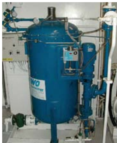
Exempel på länsvattenseparator ombord på fartyg. (Källa: DNV)
